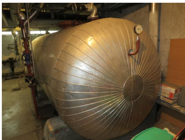
Sl. 3-17: Veliki ležeći spremnik PTV u višestambenoj zgradi
