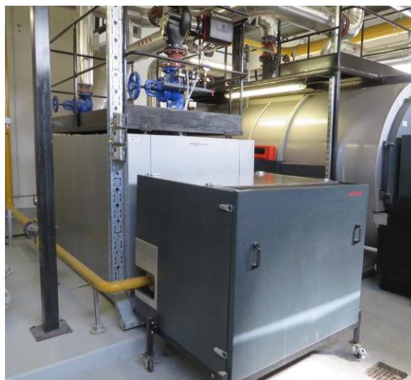
Sl. 3-13: Plinski kondenzacijski kotao
