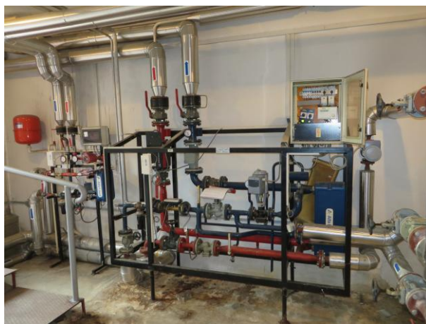
Sl. 2-44: Primjer indirektna toplinske podstanice u stambeno-poslovnoj zgradi u Zagrebu (HR-10000-3296-1)
