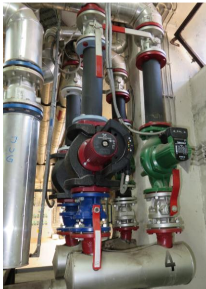
Sl. 3-12: Cirkulacijske pumpe u sustavu grijanja – frekventno upravljana radna pumpa (lijevo) i trostupanjska rezervna pumpa (desno)
