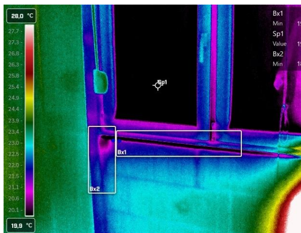
Infiltracija na mjestu ugradnje prozora
