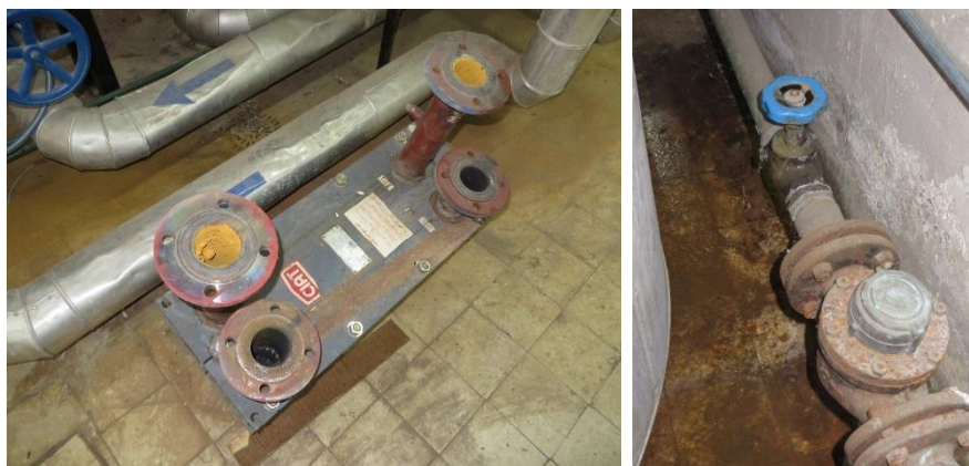
Sl. 3-27: Vidljivi tragovi korozije u cijevima sekundara izmjenjivača topline (lijevo) i propuštanje na ventilu dovoda hladne vode u spremnik PTV (desno)
