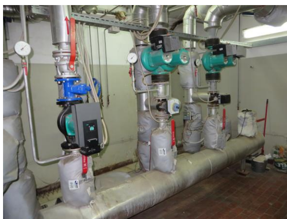
Sl. 3-11: Toplinska izolacija cjevovoda u toplinskoj podstanici
